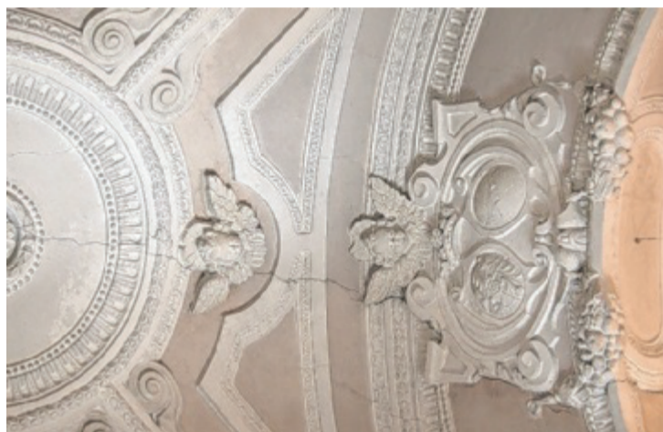
Seit Jahrzehnten ziehen sich Risse durch die Decke der Kapelle.
